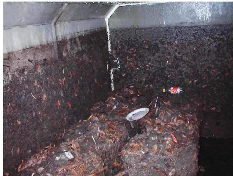
(d) StormScreen vault, September 24, 2003
