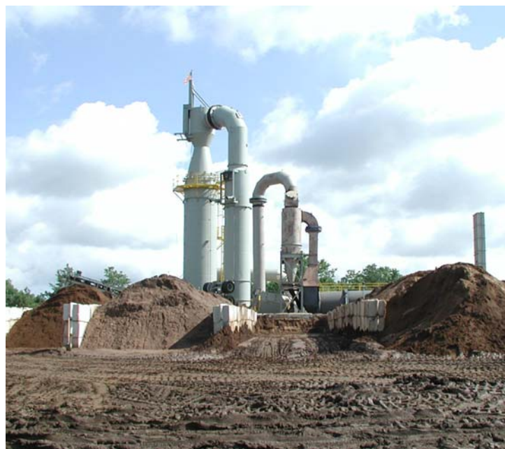
Thermal Desorption Unit
