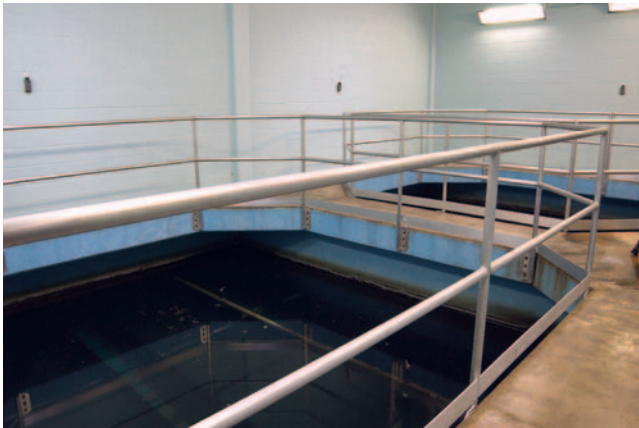
供水系統過濾箱
